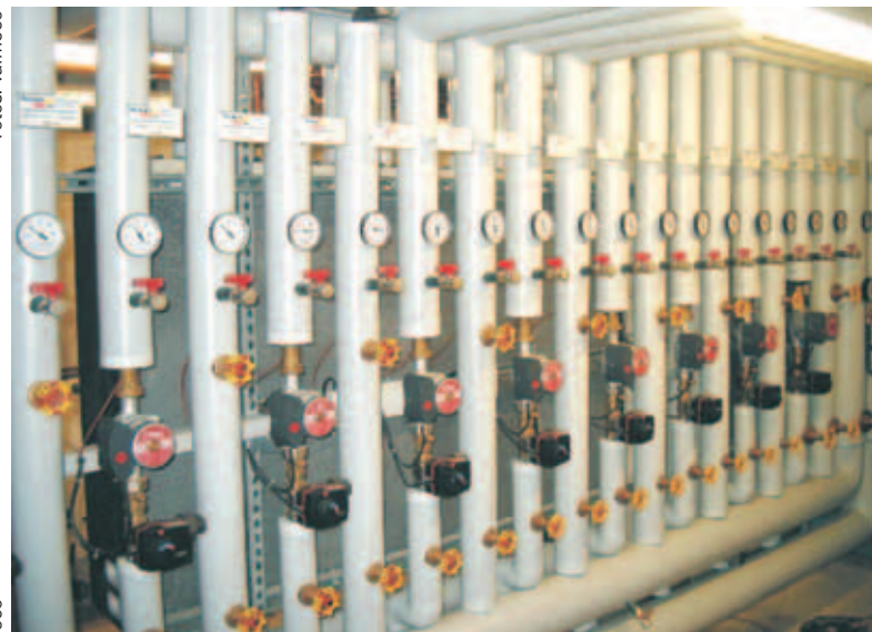
Ganz ohne das sonst gewohnte Rohrwirrwarr sieht man hier den Heizungshauptverteiler mit insgesamt zehn SYSTEM 18-geregelten Heizgruppen.
