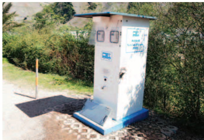
...aber auch Ver- und Entsorgungssäulen sind ein Muss.
