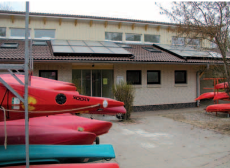
Das Prinzip der Solarthermie kommt gerade Campingplatzbetreibern sehr entgegen: Wenn in der Hochsaison der Bedarf an warmem Brauchwasser am größten ist, ist auch die solare Ausbeute am höchsten.
