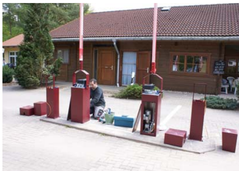
Die neue Schrankenanlage schiebt jeglichem Missbrauch durch Gäste, die sich häufig an der alten Anlage vorbeimogelten, erfolgreich einen Riegel vor.
